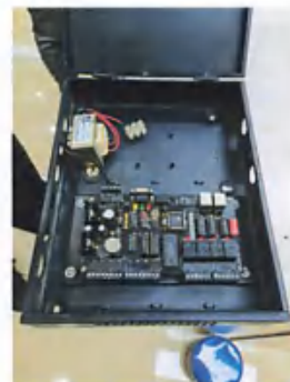
楼宇监控设备
